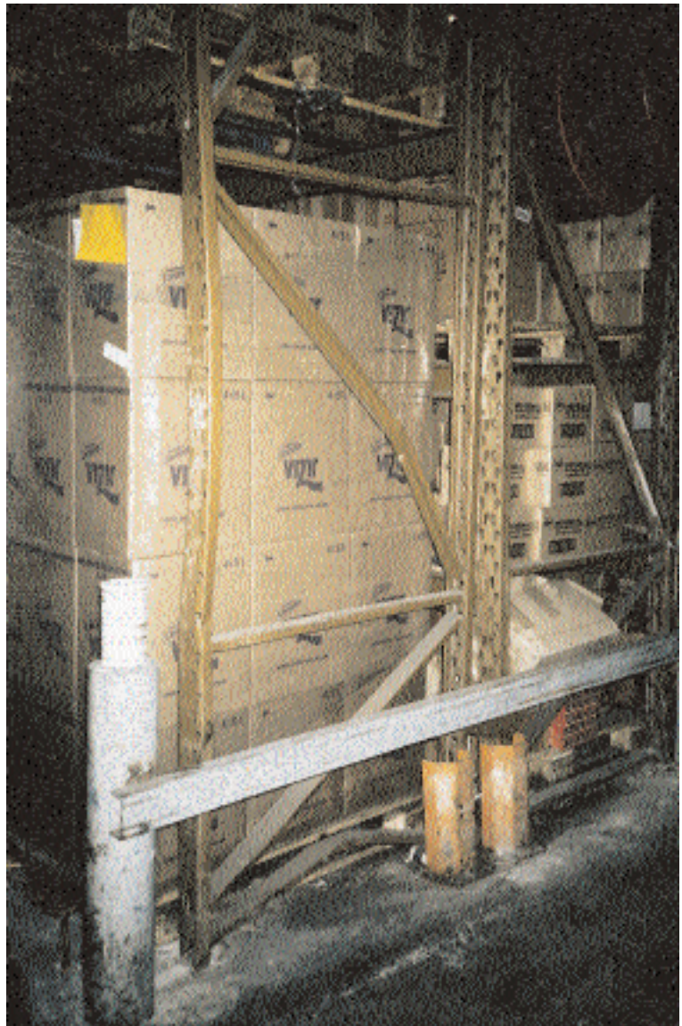
Structure détériorée : à remplacer.
